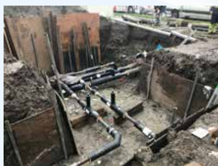
Les trois bâtiments du quartier Rabot sont raccordés au réseau de chauffage urbain par une seule connexion.
