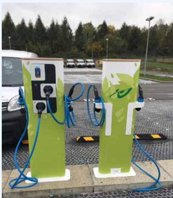
Deux bornes, soit quatre points de charge, installées chez bpost.
