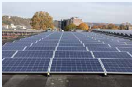
Panneaux photovoltaïques installés sur le toit de l'école polytechnique de Huy.
