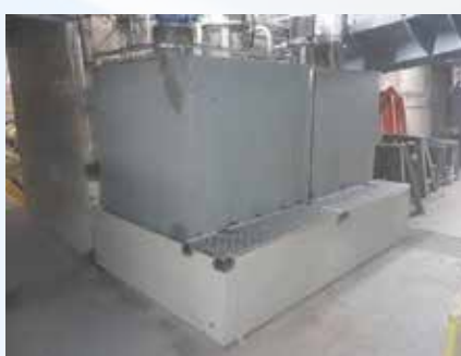
Le bac de rétention remis en place avec son double encuvement au niveau inférieur de la centrale.
