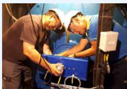
Placement du capteur de survitesse de la turbine.
