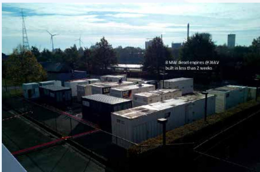
Neuf moteurs diesel de 8 MW ont été installés sur le site de Ringvaart en moins de deux semaines.
