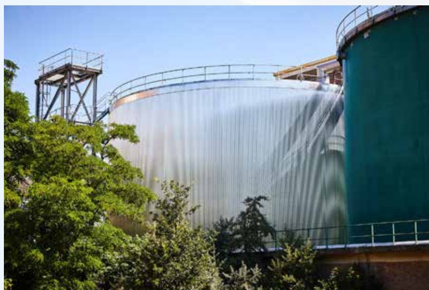
Une ancienne cuve de stockage de fuel lourd (au milieu de la photo) a été transformée en installation de stockage d'eau chaude pour réduire les émissions liées à l'alimentation du réseau de chauffage urbain de la ville de Gand. Une paroi isolante extérieure entoure la cuve pour préserver la chaleur.
