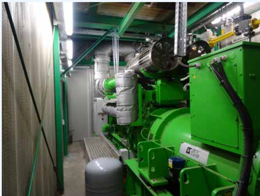
La nouvelle unité de cogénération.
