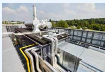
Le placement d'une cogénération sur le toit du bâtiment représente un défi technique, relevé clé en mains par Vanparijs Engineers.
