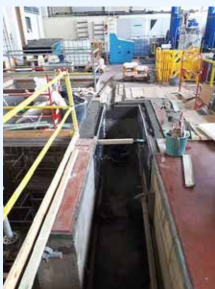
Préparation du génie civil pour la mise en place du bac de régulation machine au niveau supérieur de la centrale.
