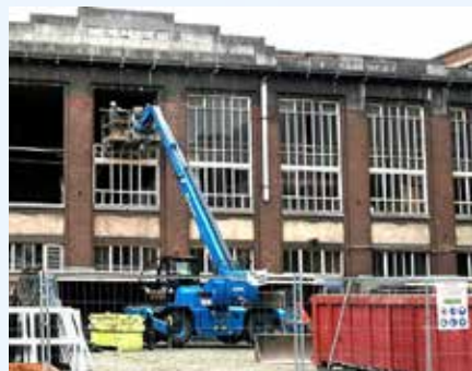
Remplacement des châssis dans le cadre du contrat de performance énergétique signé en 2016.
