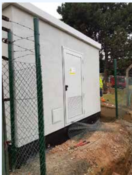
Installation de la cabine haute-tension.
