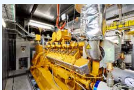
Le moteur de l'unité de cogénération dans son enceinte acoustique.
