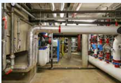
Les nouvelles installations de chauffage.
