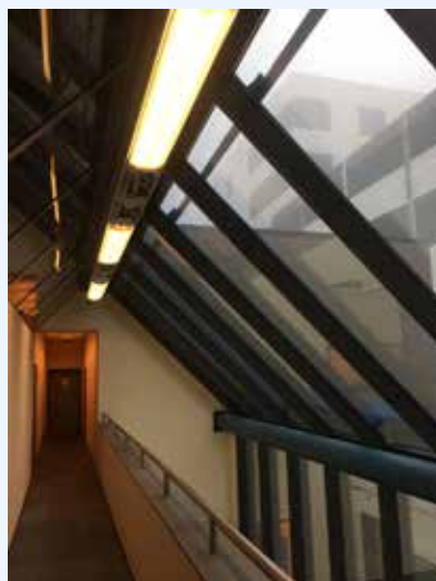
L'éclairage du site de Ringvaart a été remplacé par un éclairage LED.
