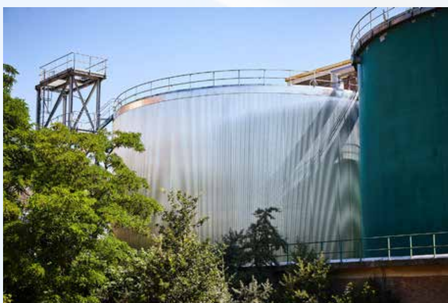
Een oude opslagtank voor olie (in het midden van de foto) werd omgevormd tot een opslagplaats voor warm water om de uitstoot met betrekking tot de voeding van het stadsverwarmingsnet van Gent te verminderen. De tank is omhuld met een isolerende buitenwand om de warmte te bewaren.
