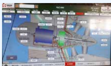
De intuïtieve gebruikersinterface op de nieuwe elektriciteitskasten van Ampsin.
