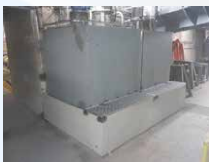
De retentietank geïnstalleerd met dubbele inkuiping op het lagere niveau van de centrale.
