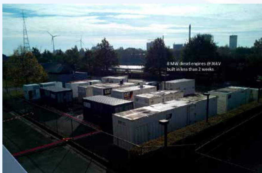
Op de Ringvaartsite werden in minder dan 2 weken negen dieselmotoren van 8 MW geïnstalleerd.
