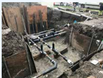
De drie gebouwen van de Rabotwijk zijn aangesloten op het stadsverwarmingsnet via één enkele verbinding.
