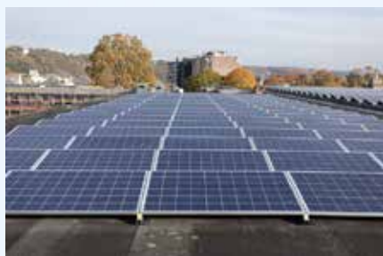
Zonnepanelen op het dak van de polytechnische school van Hoei.
